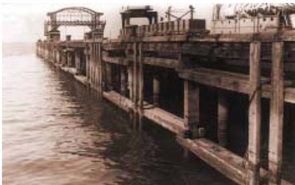
Reparación efectuada en el Muelle Norte tras un incendio.
